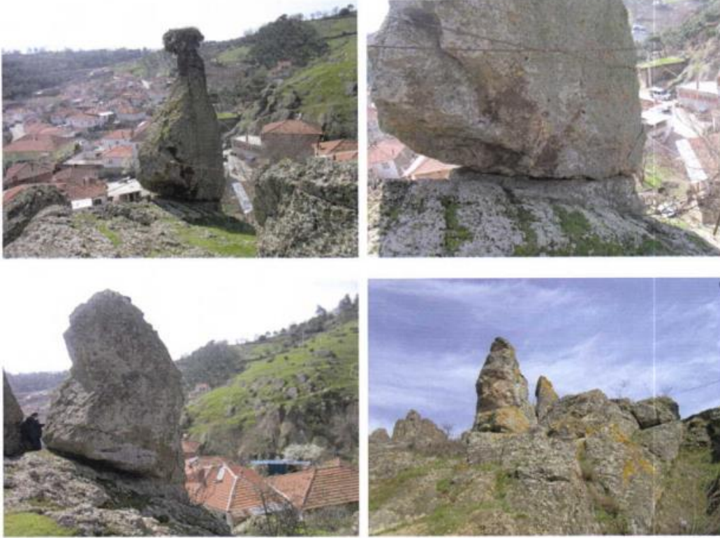
Resim 2.1. Kaya Düşme Tehlikesi Bulunan İvrindi ilçesi Çarkacı Mahallesi’ne Ait Görünüm
